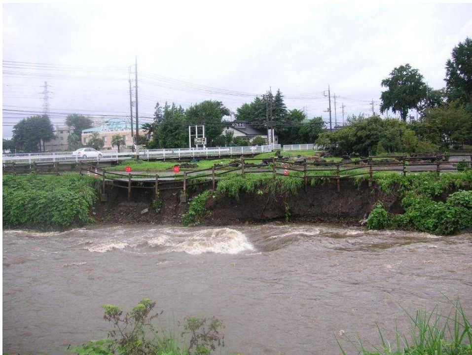
早川護岸崩落状況（伊勢崎市）
