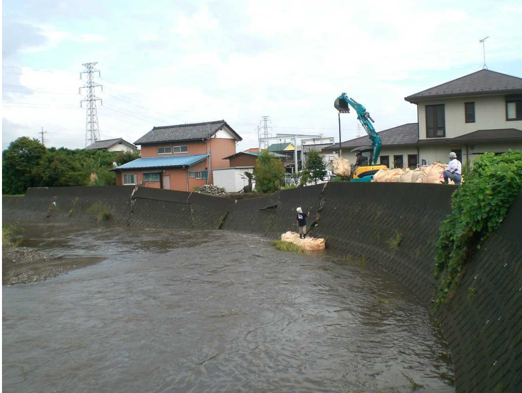
染谷川護岸崩落状況（高崎市）
