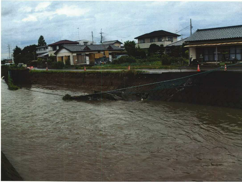
大川護岸崩落状況（伊勢崎市）
